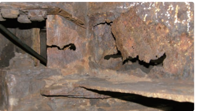
桁橋の腐食(放って置くとこの様な状態になります)
